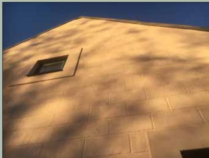
Isokalk på gavlen av Arendalsgata 45, Oslo, i samråd med byantikvaren. Bygningen er oppført i hul betongstein som er fuget. Fuger og detaljer er gjenskapt i slutt puss.
