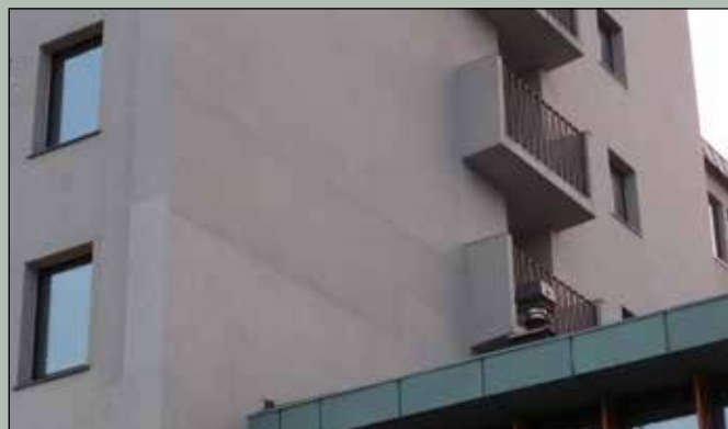
Synlige skjøter på ett-trinns system på Hotel Atlantic i Stavanger, ett år etter ferdigstillelse (foto 6.11.2018).
