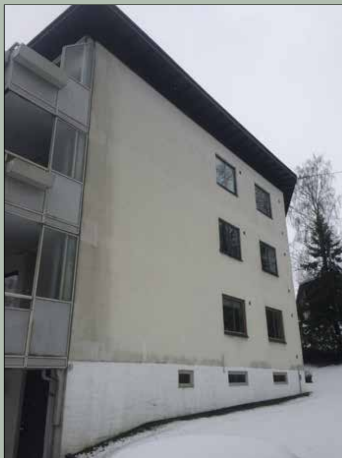
Vannskader i vegg på borettslag i Oslo; Siporex brukt som etterisolering utenpå betongvegger.
