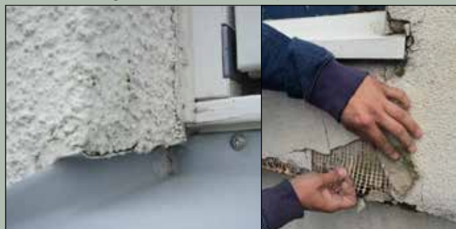
En tilsynelatende liten svakhet ved vindusdetalj gir vannoppsamling inne i mineraloppfylt vegg og etterhvert store skader.
